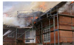
Folgen von Lötarbeiten des Dachdeckers an der Dachrinne
